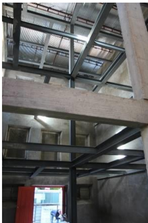
Fig. 19 – Perspectiva interior da consolidação e reforço estrutural do edifício levados a cabo a partir de 2008. Foto: Museu Municipal.
