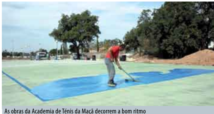
As obras da Academia de Ténis da Maça decorrem a bom ritmo
