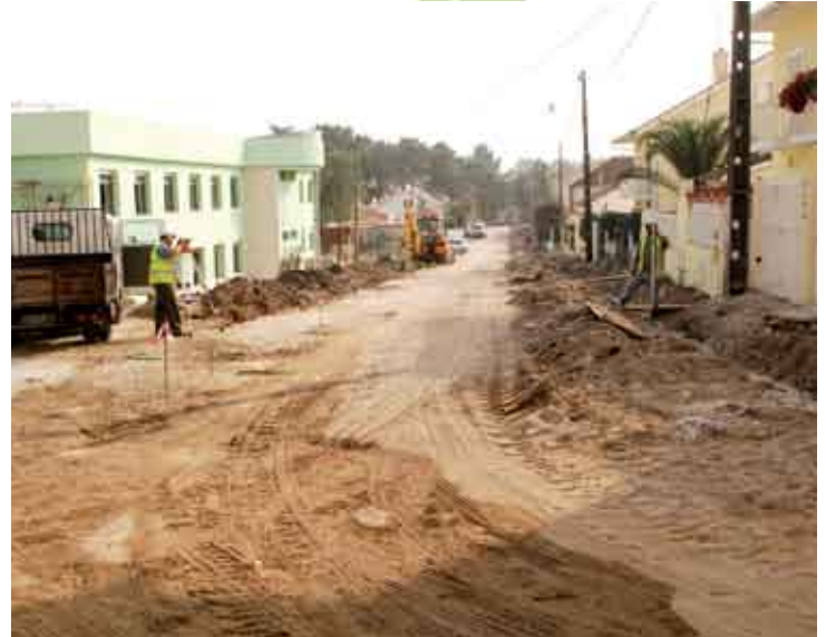
As pavimentações na Boa Água 1 devem estar concluídas no segundo semestre de 2010
