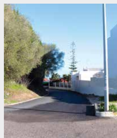
Troço de ligação entre as ruas Altinho da Cotovia e João de Lemos Cotovia • Freguesia do Castelo Estado: Concluída
